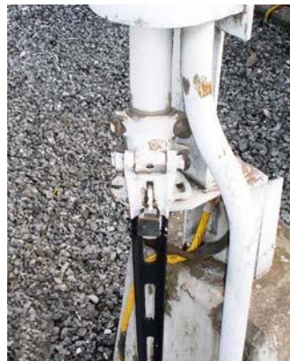
Travamentos e bloqueios de dispositivos e sistemas de manobra e comandos
